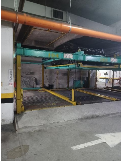
↑位於蘆洲區「吾愛吾家社區」內之機械式停車位。
